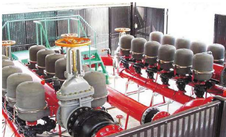
大型自動逆洗フィルター「ギャラクシーシステム」 (CV=239ℓ/sec) ギャラクシー24連結(岡山県倉敷地方振興局)
