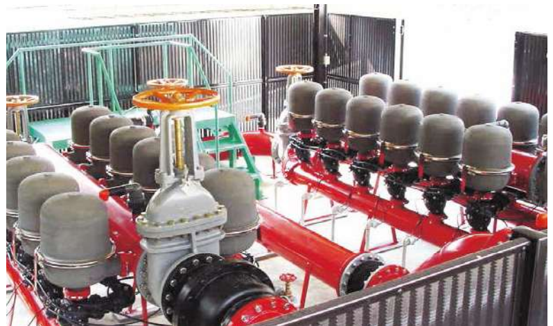
大型自動逆洗フィルター「ギャラクシーシステム」 (CV=239 l/sec) ギャラクシー24連結(岡山県倉敷地方振興局)
